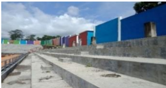
Gambar 1. Kondisi Tribun Penonton Stadion Kebogiro (Sumber: Penulis, 2023)
