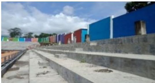
Gambar 1. Kondisi Tribun Penonton Stadion Kebogiro (Sumber: Penulis, 2023)
